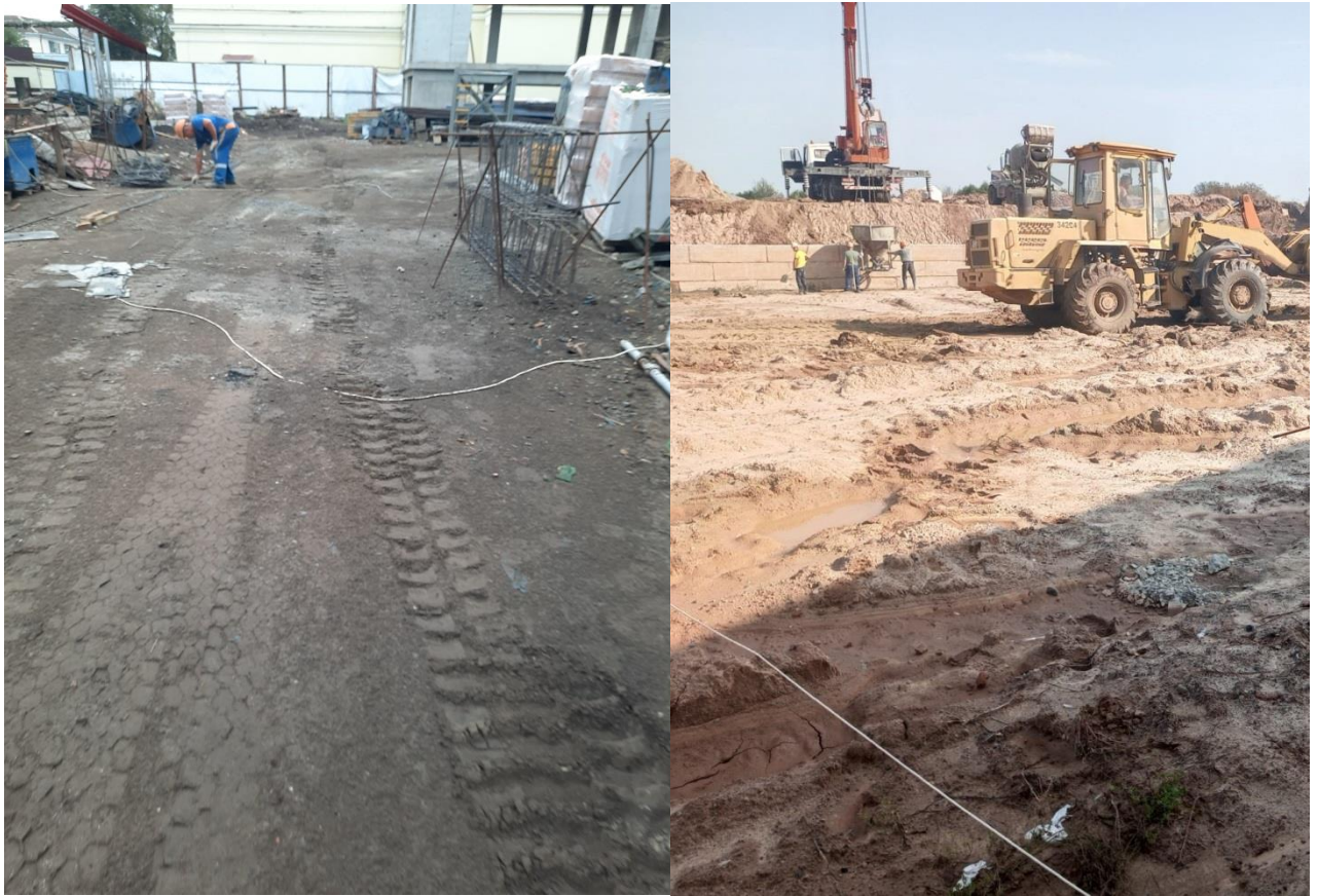
Разводка временных электросетей, используемых при электроснабжении объекта строительства, выполнена изолированными проводами и кабелями по земле
